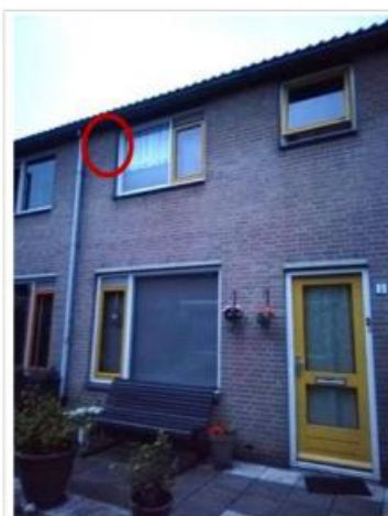
Figuur 3.2 Aangetroffen zomerverblijfplaats van de gewone dwergvleermuis aan de voorzijde van de Knieboomgaard 5 in een open stoetvoeg.
