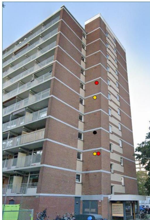
Figuur 2 Weergave van invliegopeningen in het flatgebouw Arend. Alle openingen betreffen ventilatieroosters.
