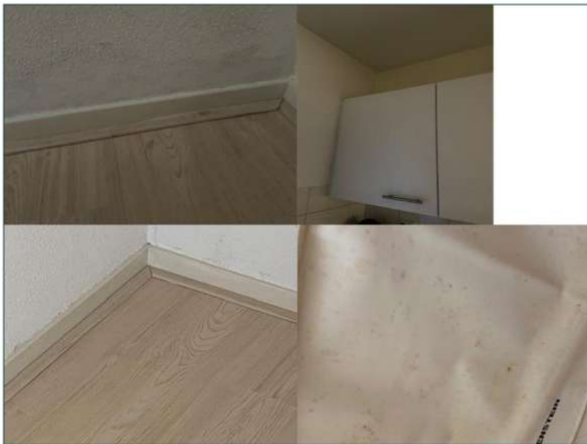
Figuur 4 Vocht- en schimmelvlekken in de woningen veroorzaakt door achterstallig onderhoud. Bron: Blom Ecologie (2024)
