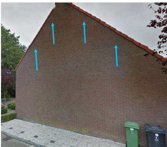
Afbeelding 2: tijdelijke kasten op de kopgevel van de Zoutziederstraat 1, gericht op het westen. Ditzelfde is geplaatst op de Zoutziederstraat 10, gericht op het oosten
