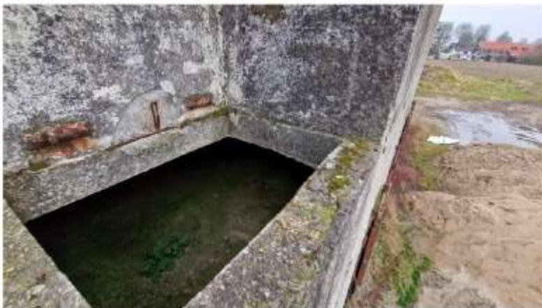
Afbeelding 13: De "rootbakken", bovenkamers in de vlasroterij met een opening aan de bovenzijde. Deze ruimtes zijn uit veiligheidsoverwegingen niet van binnen geïnspecteerd.
